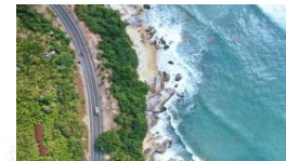
沿海高盐腐蚀
