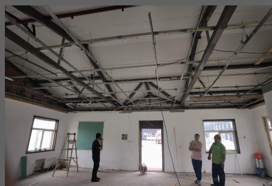
室内办公用电布线
