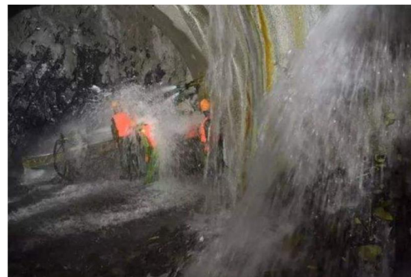
某隧道揭露的热水
